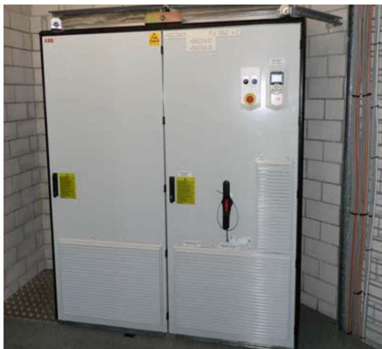
Schaltschrank des neuen Frequenzumrichters vom Saugzug 4.2
