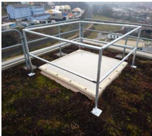
Gesichertes Oberlicht um das Begehen und einen möglichen Sturz durch das Oberlicht zu verhindern.
